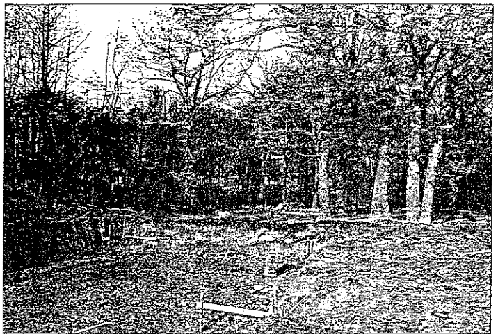
Schwer geschädigt wurde das Wurzelwerk der drei Eichen bei Ausschachtungsarbeiten für Einfamilienhäuser am Sanddornweg. Die Haaner Bauaufsicht ist eingeschaltet. In der Verwaltung gibt es Überlegungen, eine neue Baumschutzsatzung zu erarbeiten.
